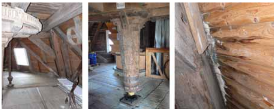
Till vänster: Broloftet. Mitten: Kvarnloftet. Till höger: Fuktskada.
