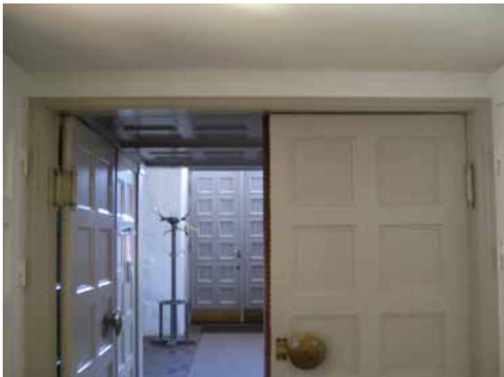
Parti över entrén in till kyrkorummet från vapenhuset i väster. Kablage från elcentral till respektive sida mittgången är dolt bakom en täckskiva ovan dörrkarmen.
