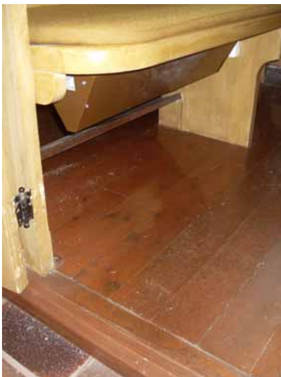
De brunlackerade konvektorerna är placerade på bänksitsarnas undersidor.
