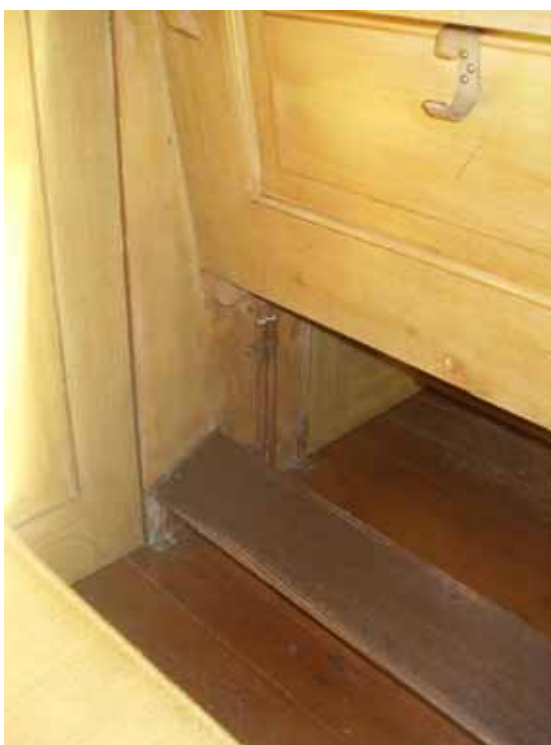
Det synliga kablaget är inmålat i bänkinredningens kulör för att smälta in så mycket som möjligt.
