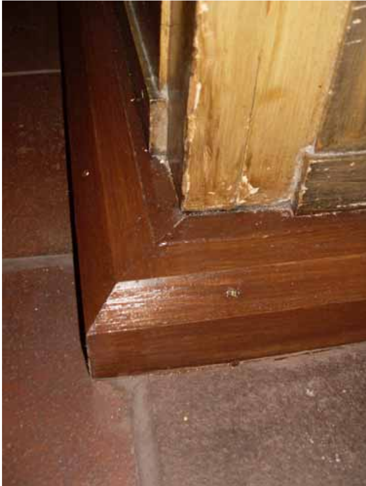
Bänkinredningens påbyggda sockellist som döljer kablaget till bänkkonvektorer.
