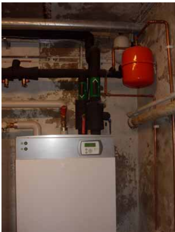
Bergvärmepumpen samt expansionskärlat monterat i pannrummet.
