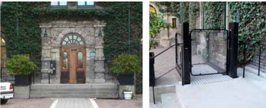
Entrén efter ombyggnaden. Trappan har byggts ut så att ett större vilplan bildats, och hiss har installerats. När bilden togs var den tillgänglighetsanpassade ytterdörren ännu inte helt färdig, då den ska förses med skyddsplåt i koppar på nedre delen.
